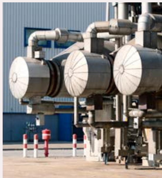
Blick auf die Olefin-Anlage in der Ruhr Oel Raffinerie in Gelsenkirchen-Scholven
