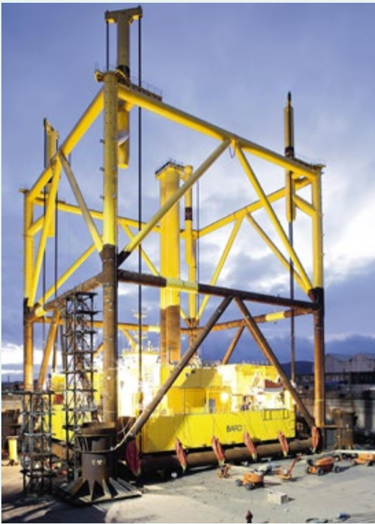
Eine Konverterplattform – eine Art Umspannwerk für Offshore-Windkraftanlagen – vor dem Einbau im Windpark BARD Offshore 1
