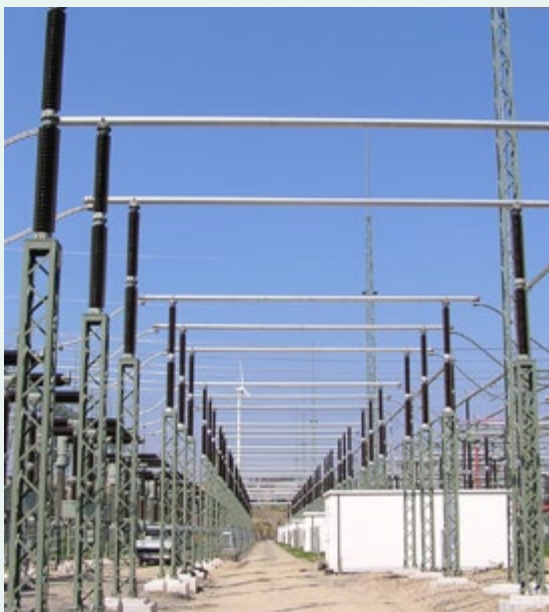
Das Umspannwerk Remptendorf ist ein wichtiger Bestandteil des thüringischen Stromnetzes
